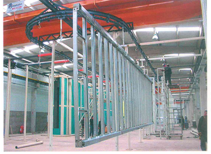
Çelik Konstriksiyon Boyama Tesisleri Steel Constriction Painting Lines
